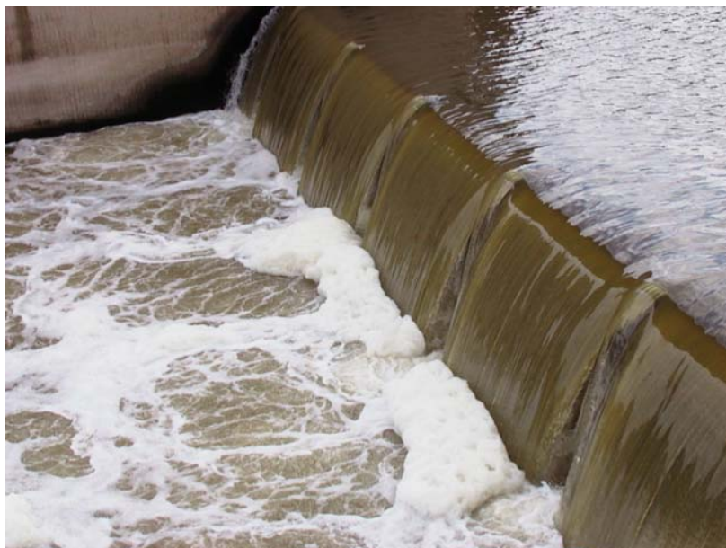
Een overstort om het debiet en waterpeil te regelen in een kanaal.
