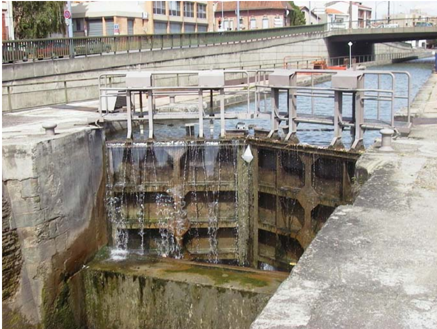
De sluisdeuren staan in een hoek tegen elkaar om de druk van het water op te vangen.
