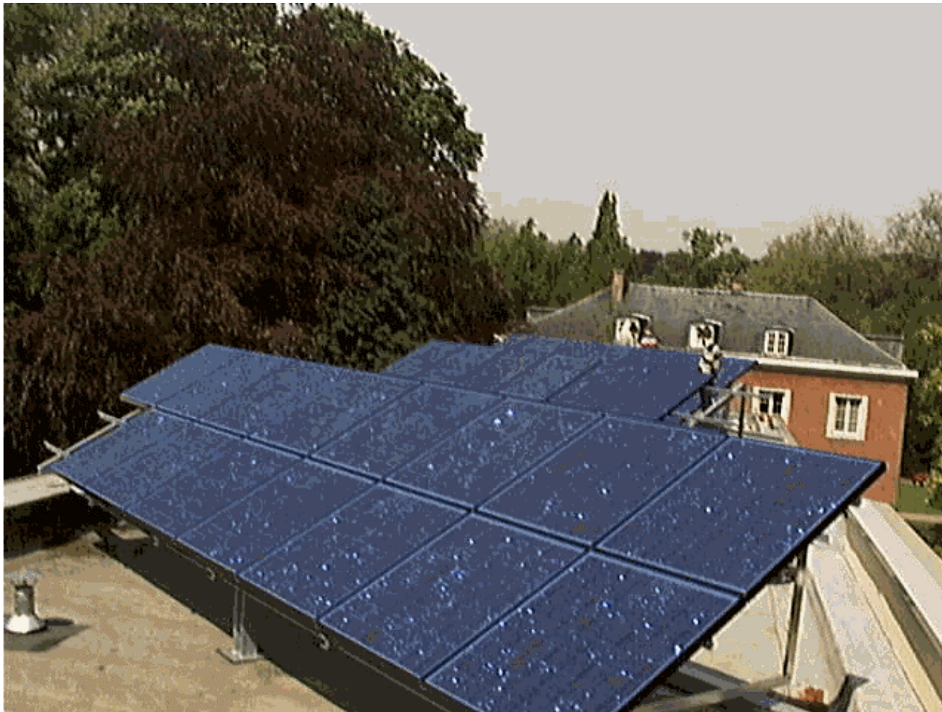
Dakgeïnstalleerde zonnencelinstallatie K.U.Leuven (Foto ELECTA)
