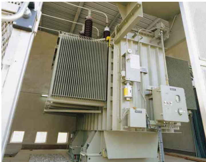
Transformateur France-Transfo 63/20 kV.
