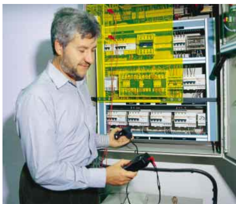
Armoire de distribution installée à l'IUFM - Saint-Denis.
